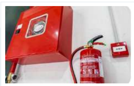
Medios de protección contra incendios
